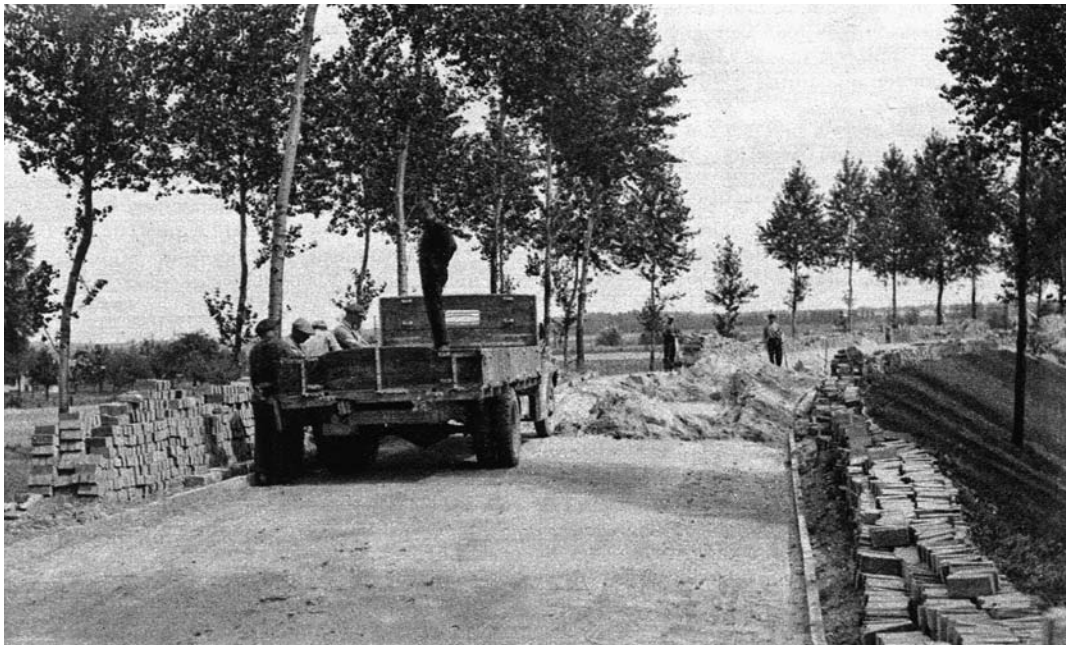
De aanleg van de provinciale weg tussen Kruiningen en de haven bij Hansweert. De weg zou worden gebruikt door autobussen die fungeerden als schakel tussen treinstation Kruiningen en de provinciale stoomboten op de Westerschelde. Ons Zeeland , 1936, nr 36, pag. 24.
